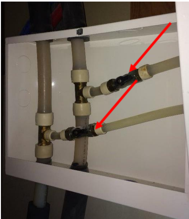
Ventiler bakom ännu en lucka bakom kyl/frys.
